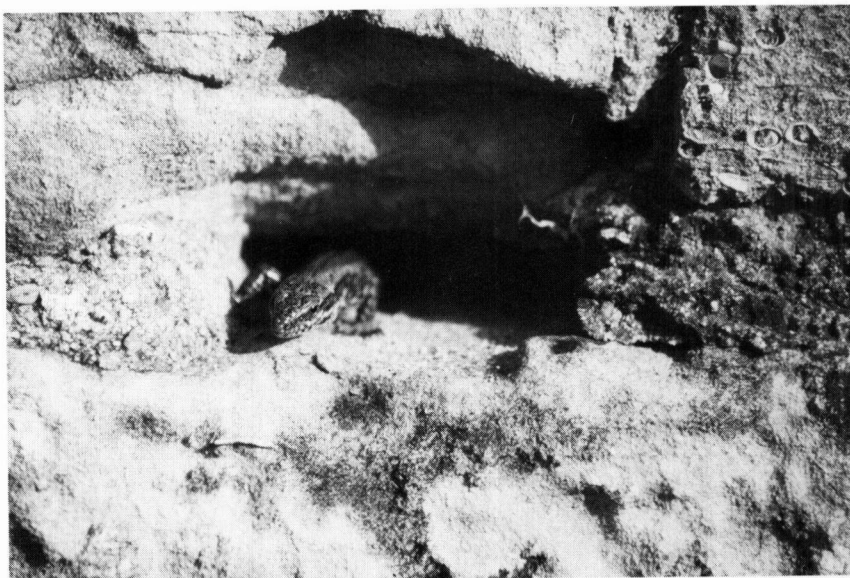
Figuur 5. Muurhagedis-♀ zonnend in een hol, dat ontstaan is doordat het bij de restauratie gebruikte harde Portland-cement als gevolg van verwerking weer heeft losgelaten.
